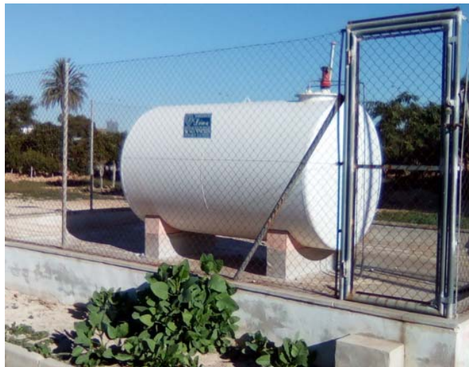
Imagen 15. Depósito Gas Propano
