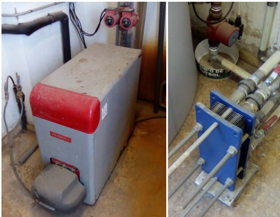
Imagen 6. Instalación ACS Pabellón
